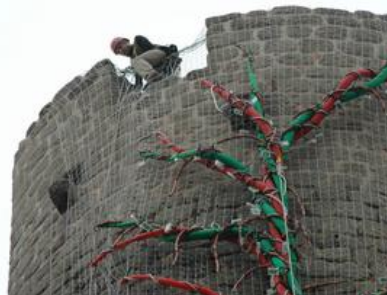
L'installation des capteurs solaires se termine au château d'Andlau. La semaine prochaine, les premiers points lumineux devraient apparaître dans la nuit. (Photo DNA)
